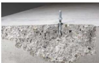
Разрушение от откалывания края основания
