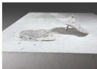
Разрушение от выкалывания бетона основания
